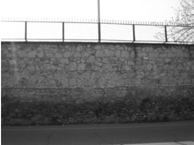
fig.7.5 VIA DEL MANDRIONE - WALL
