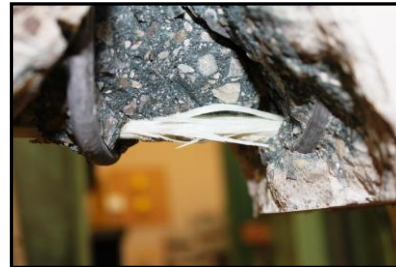
(d) Close up view of failure side
