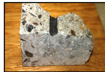
(d) Bond failure interface
