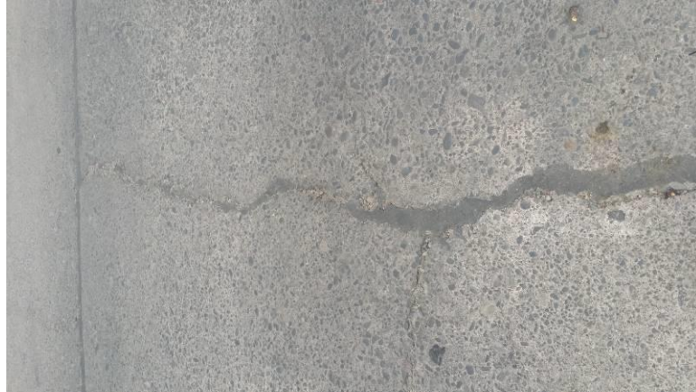
Figura 9-4. Grieta transversal de alta severidad. Pavimento de Hormigón
