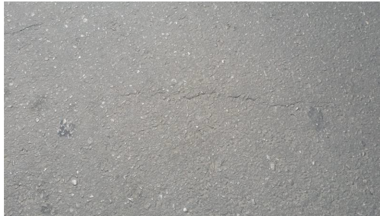
Figura 9-2. Grietas de transversal de baja severidad
