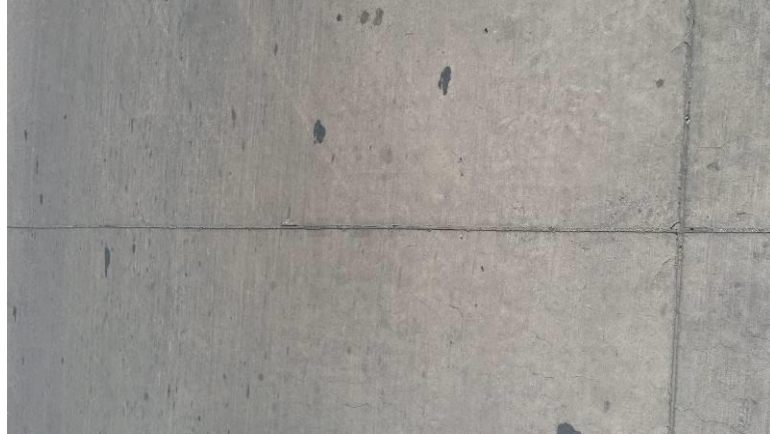
Figura 9-5. Deterioro de Sello de Junta de baja severidad
