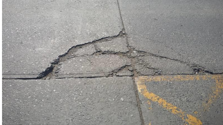
Figura 9-3. Grieta Esquina de Alta Severidad
