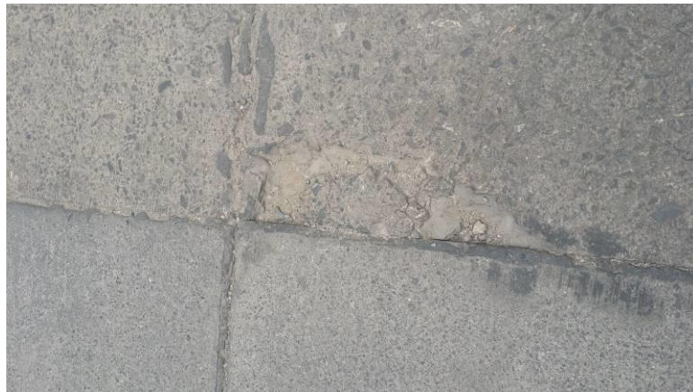
Figura 9-6. Desconche de Junta de Alta Severidad
