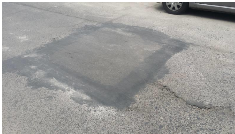
Figura 9-7. Parche Deteriorado de Severidad Media
