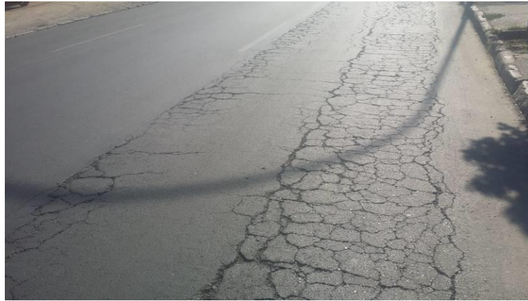
Figura 9-1. Grietas de Fatiga de Alta Severidad
